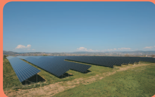
Centrale solaire de Manosque « La Fito »
